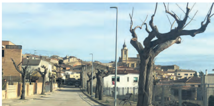
Las nuevas luminarias ya están instaladas en algunas zonas. NDM
