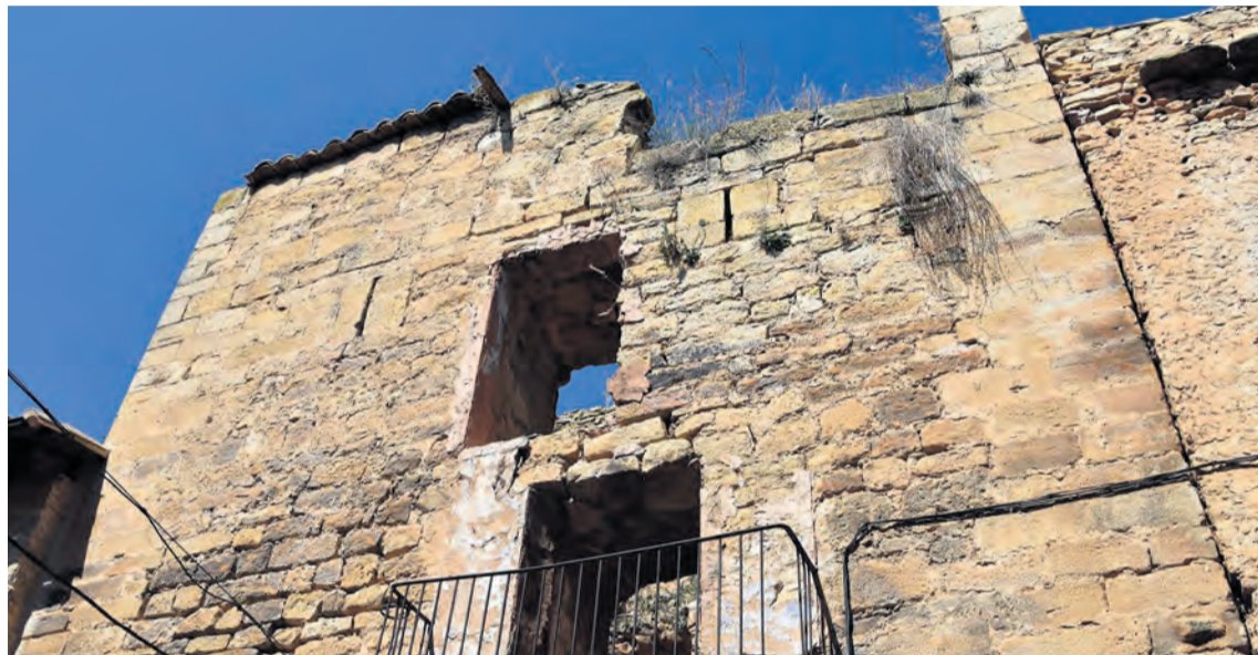
La torre se encuentra actualmente en muy mal estado de conservación. Marta Jiménez
