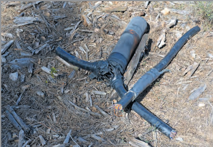
En la zona del Tastavins está desapareciendo todo el cable. R. L.
